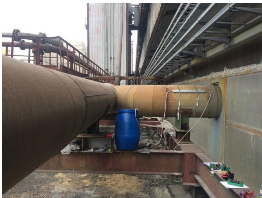
Рис. 3. Общий вид блока термоэлектрического преобразования, установленного на участке газопровода Fig. 3. General view of the thermoelectric conversion unit installed in the gas duct section
