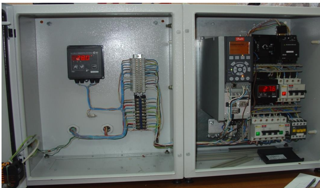
Рис. 4. Внутренний вид шкафов управления автоматизированной системы научных исследований Fig. 4. Internal view of the control cabinets of the automated system of scientific studies
